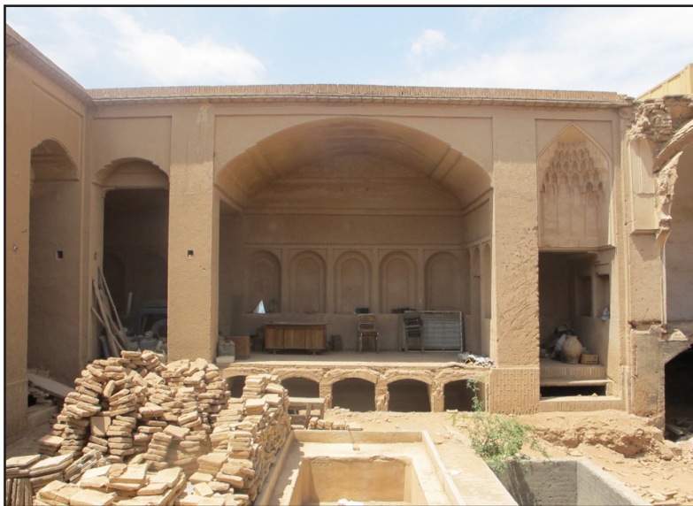
تصویر ۶. بادگیر و ضلع شمالی خانه مهدی اعلم (مأخذ: پرونده ثبت اثر).
